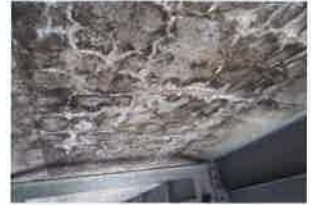
中村川橋の損傷状況
